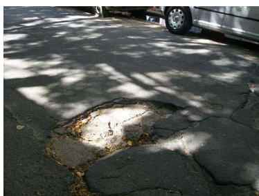
CAMPOS SALLES 1800 FECHA: 17/03/09 N° RECLAMO: 00048766/09
