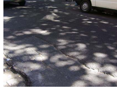
COCHABAMBA 400 FECHA: 08/03/09 N° RECLAMO: 00040660/09
