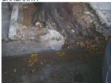
DORREGO AV. 1532 FECHA: 03/03/09 N° RECLAMO: 00036592/09
